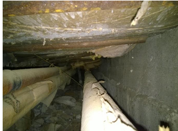
Kuva 8: Putkikanaaleissa kulkee lämmitysputkistoja.
