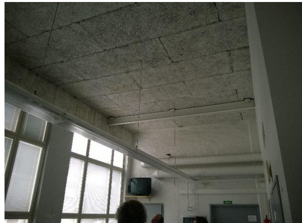
Kuva 16: Ulkoseinien yläosissa on havaittavissa vesivuotoihin viittaavia jälkiä.
