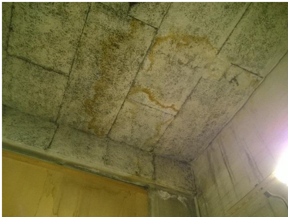
Kuva 15: Ulkoseinien yläosissa on havaittavissa vesivuotoihin viittaavia jälkiä.
