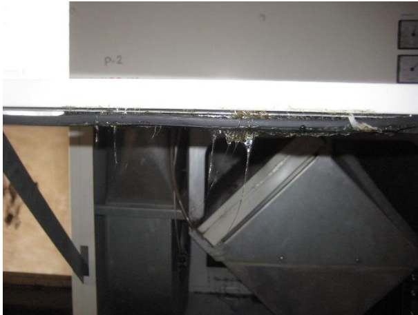
Kuva 33. P-2 tarkennekuva, josta erottuu tiivistepinnan rikkoutuminen ja -liiman pursuaminen.
