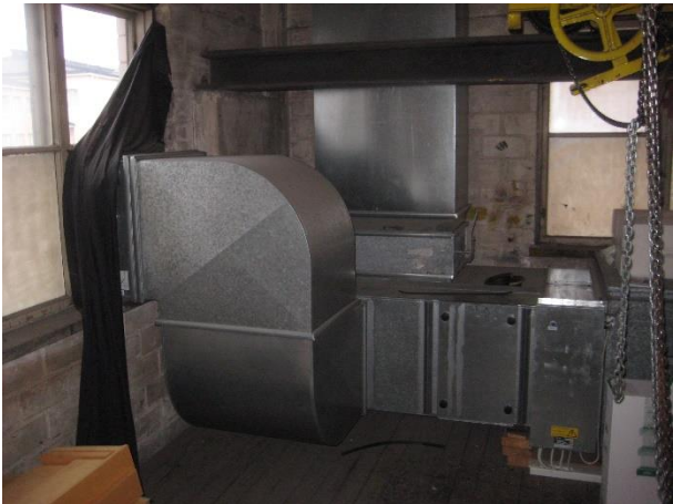
Kuva 25. Käytöstä poistettu pääilmanvaihtokone.
