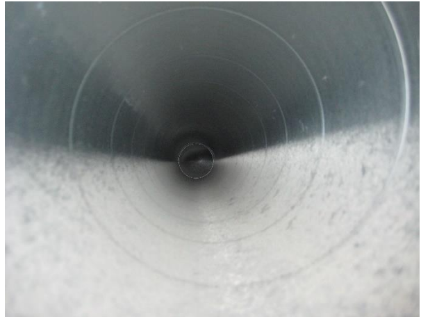
Kuva 46. Poistoilmakanava P-2 vaikutusalueella. Havaittavissa runsasta pölykertymää.
