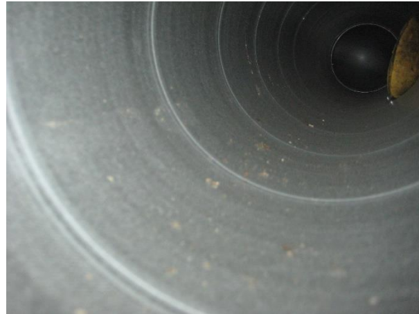
Kuva 44. Poistoilmakanava P-1 vaikutusalueella. Havaittavissa epäpuhtautta.
