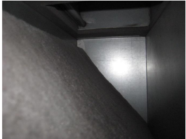
Kuva 36. P-2 suodattimet huonossa kunnossa puhtauden puolesta.
