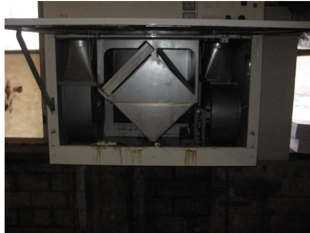
Kuva 32. P-2 yleiskuva koneen sisältä. Koneen tiivistepinnat ovat irronneet kauttaaltaan ja tiivisteliima on sotkeutunut koneen kanteen.
