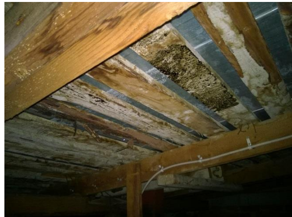
Kuva 22: Harvassa aluslaudoituksessa on huomattavia vauriojälkiä.
