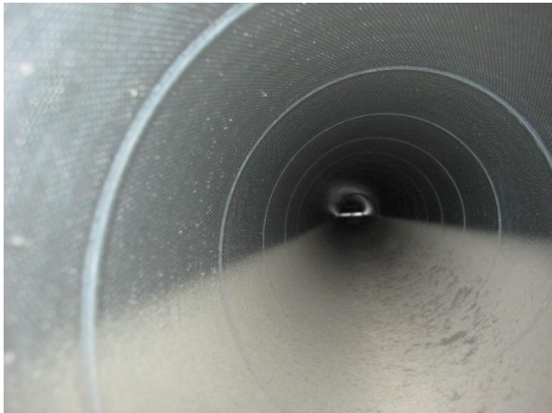
Kuva 47. Poistoilmakanava P-4 vaikutusalueella. Havaittavissa runsasta pölykertymää.
