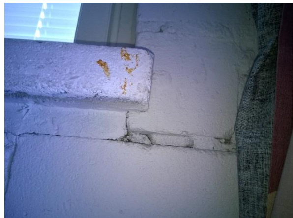
Kuva 18: Selvää vuotoa esiintyi myös ulkoseinän ja ikkunoiden liituskohdilla.
