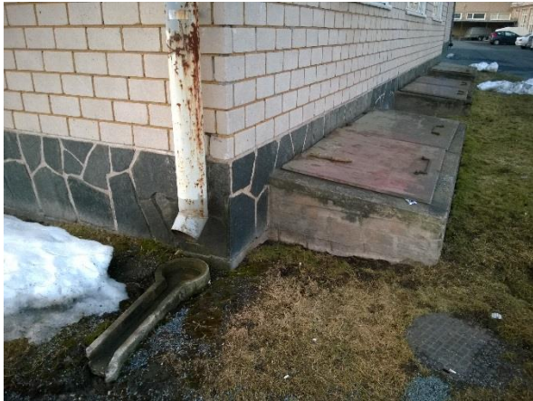
Kuva 3: Sokkelipinnoilla on havaittavissa roiskevesien aiheuttamia jälkiä.
