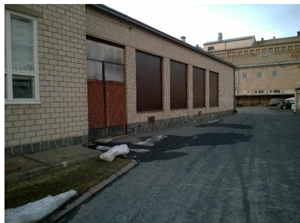
Kuva 2: Lännen puoleisella sivulla maanpinnat viettävät rakennuksesta poispäin.
