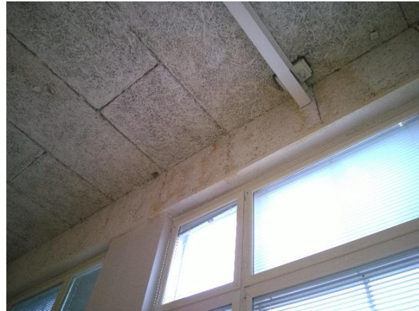
Kuva 24: Sisäkattopinnoilla havaittiin vesikattovuotoon viittaa kosteusvauriojälkiä taukotilassa.
