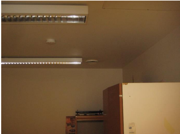
Kuva 48. Tuloilman päätelaite rakennuksen tiloissa.
