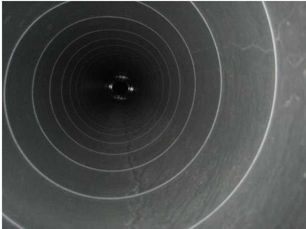
Kuva 45. Tuloilmakanava P-2 vaikutusalueella. Havaittavissa pölyisyyttä.
