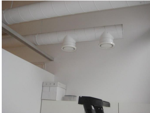
Kuva 49. Poistoilman päätelaitteita rakennuksen tiloissa.
