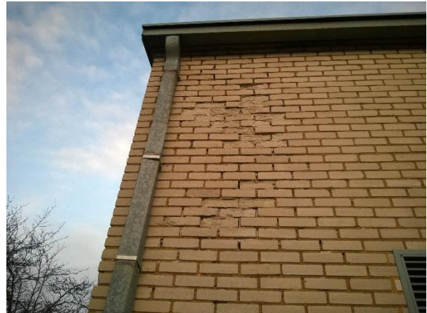
Kuva 6: Tiiliverhouksessa havaittiin kosteuden aiheuttamaa rapautumista.
