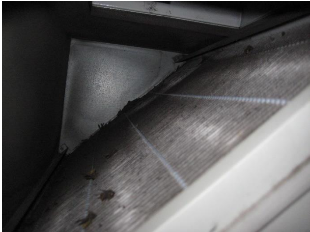
Kuva 35. P-2 raitisilman suodattimissa havaittavissa runsaasti hyönteisiä.
