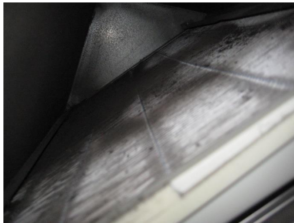
Kuva 42. P-4 raitisilmasuodattimet ovat erittäin likaiset.
