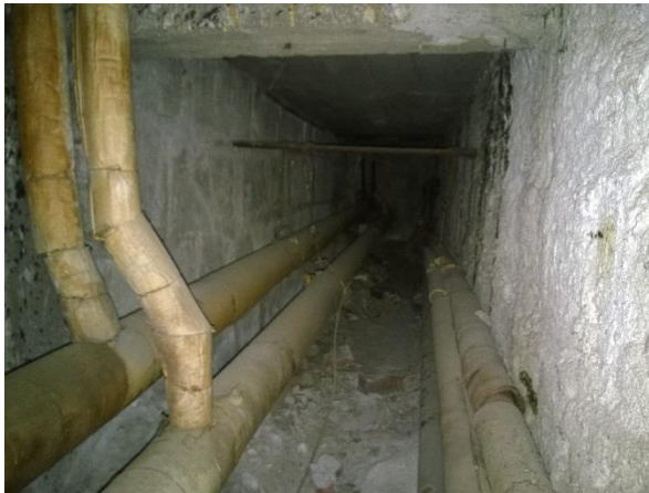
Kuva 9: Lännen puoleisessa putkikanaalissa havaittiin epäpuhtauslähteitä.
