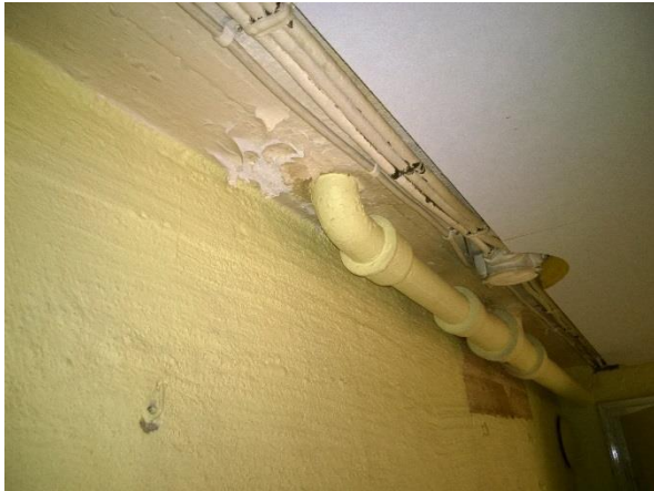
Kuva 13: Todennäköinen viemärivuoto läpivientin kohdalla.
