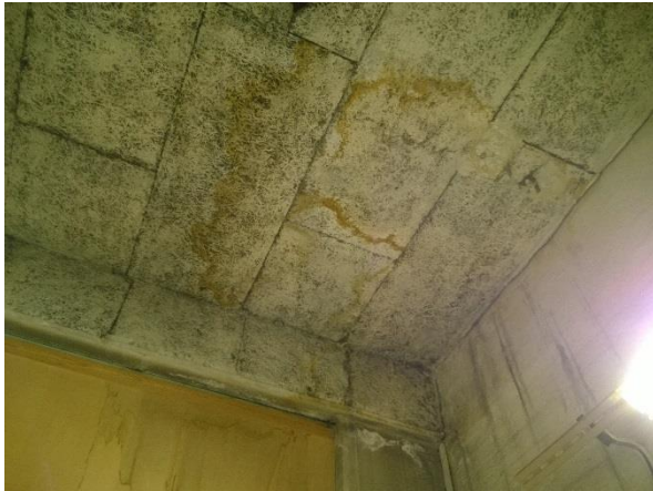
Kuva 23: Halliosalla sisäkattopinnoilla esiintyi kosteusvauriojälkiä.
