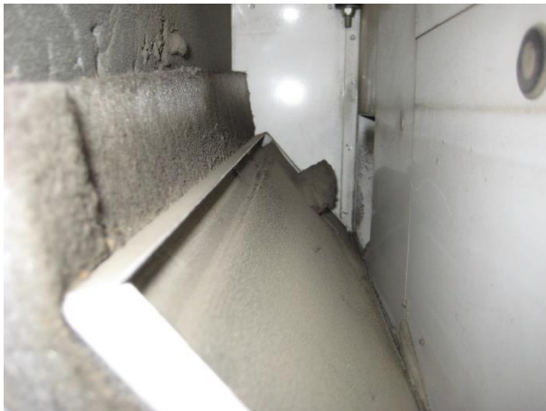
Kuva 29. P-1 raitisilmasuodatin. Havaittavissa runsaasti roskaa, sekä suodattimen sopimattomuus kehikkoon.
