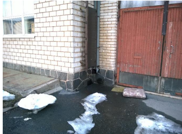
Kuva 4: Sadevesijärjestelmät ovat puutteelliset.
