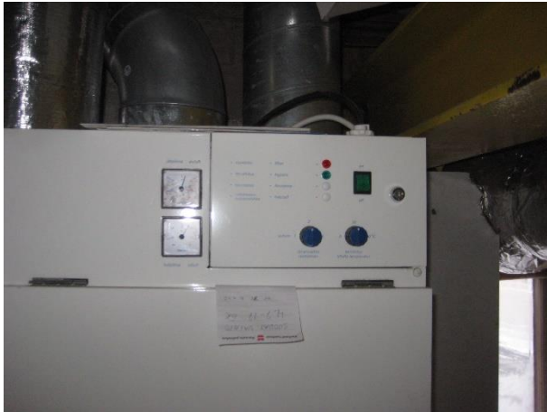
Kuva 31. P-2 yleiskuva ohjauskytkimistä.
