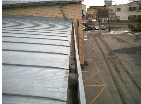
Kuva 20: Pohjoisosan sadevedet laskevat eteläosan vesikatolle. Räystäskourut ovat heikossa kunnossa.
